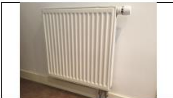
De verwarming Die Heizung
